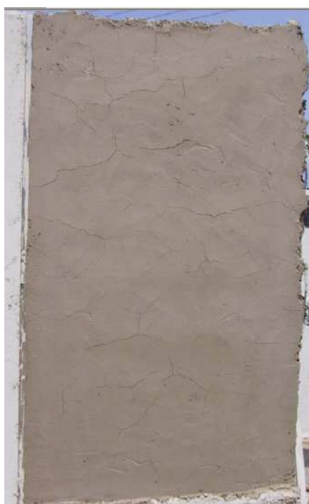
Figura 1. Fissuração apresentada pela argamassa com Saibro, logo após sua aplicação( Projeto REFA – Avaliação do desempenho dos revestimentos de fachadas)
